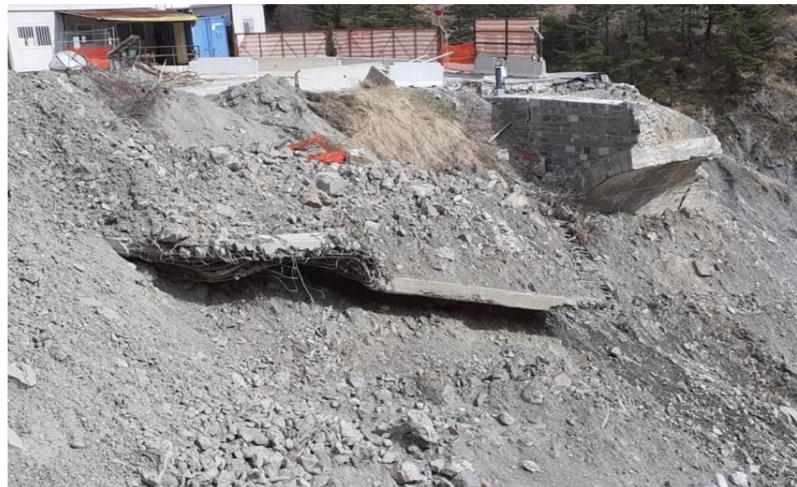
Illustration 41 Rottura del piano stradale del viadotto sul Ca
