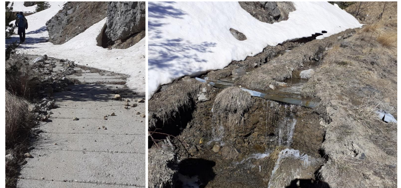
Illustration 29 Via in cemento - Conflitto tra le acque del versante e la via L'utilizzo di calcestruzzo nella via di accesso agli alpeggi per favorire l'accelerazione del ruscellamento provocò l'erosione del sentiero forestale canalizzando le acque di ruscellamento e impedendone la diffusione nel versante
