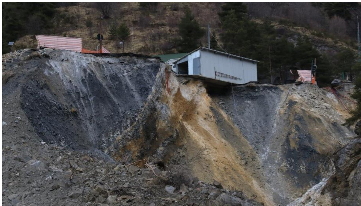
Illustration 125 Piattaforma di accesso alla canna Est - Panoramica Il fiume Roia ha eroso il suo letto fino alla roccia. Si noti che l'installazione del cantiere è "nel vuoto".
