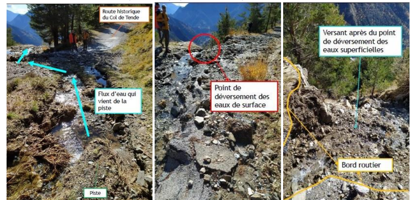
Illustration 15 : Dilavamento - Incrocio con la vecchia strada del sale - punto di scarico sul versante (Dott. VALENTE ARNALDI)
